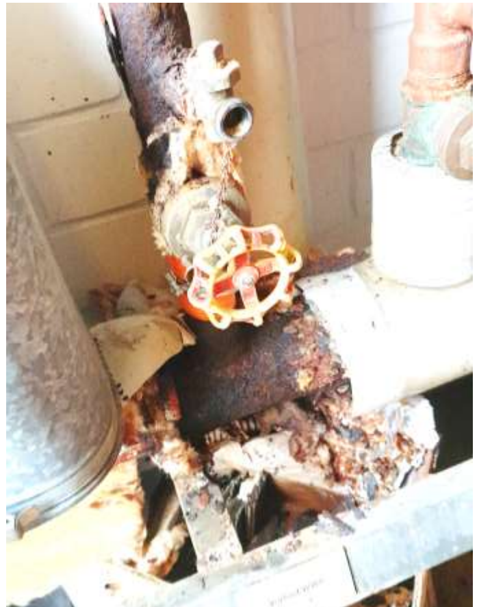
5 Verrosteter Wärmeverteiler im Übergaberaum
