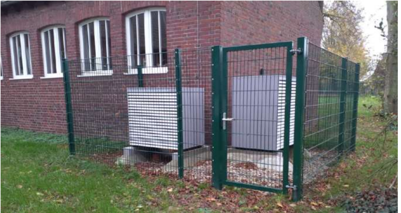
1 Wärmepumpe - Außeneinheiten 12kW und 20kW
