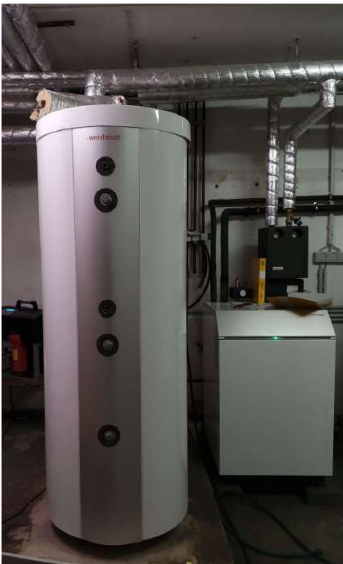
2 Wärmepumpe - Inneneinheit mit Pufferspeicher 500 l
