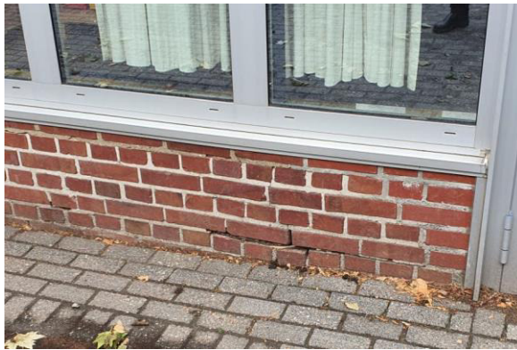
Setzungsrisse in der Mauerwerksbrüstung
