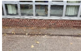
Verformungen im Außenmauerwerk
