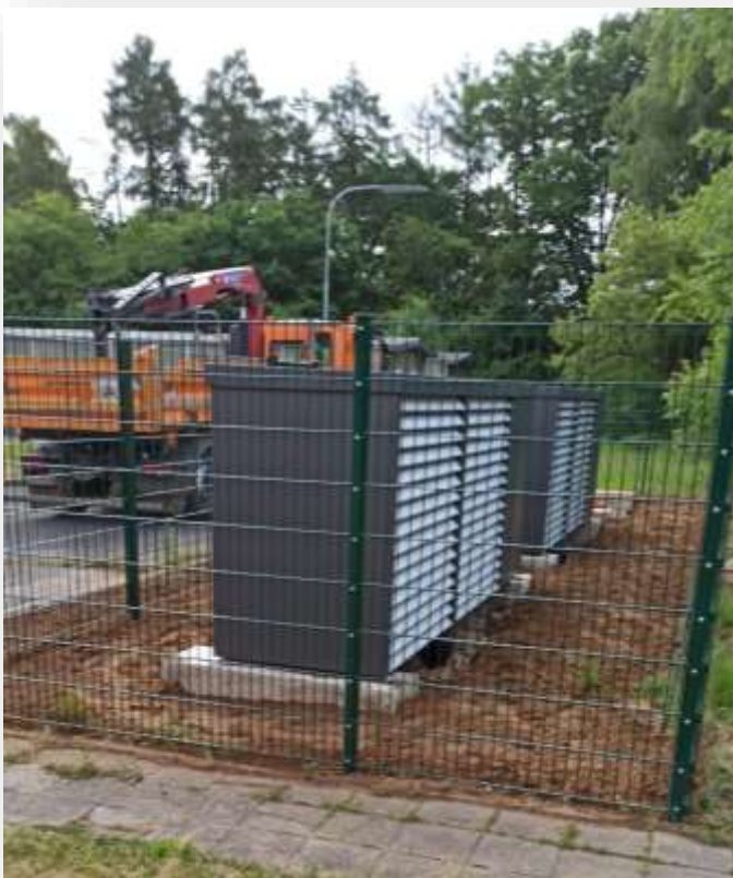
Außeneinheiten der Wärmepumpe
