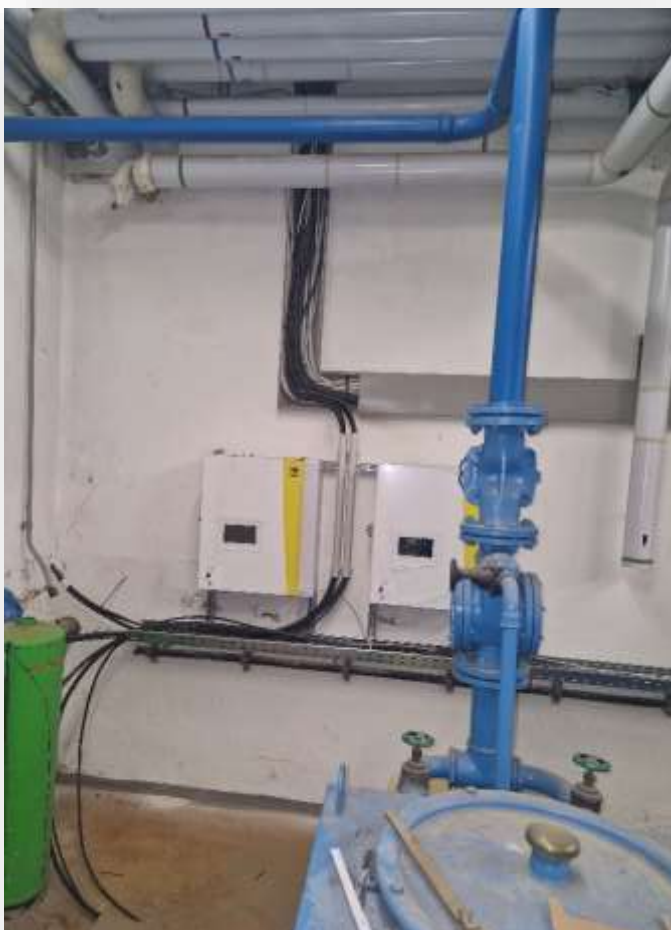
Schaltkästen / Übergabestationen im Kellergeschoss
