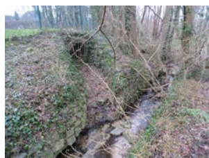
Kontrollschacht und Einleitung in Graben
