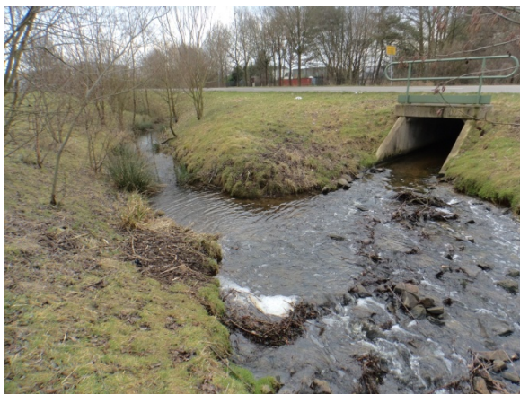
Einleitungsstelle (links) in den Beeckbach
