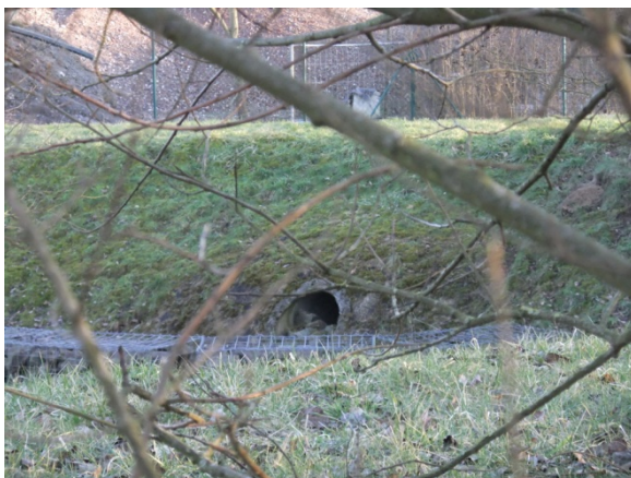
Einleitung in das RRB August-Horch-Straße
