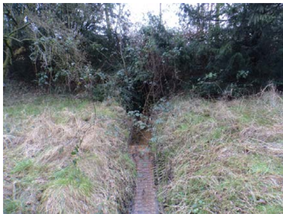
Auslasssstelle in den Graben zur Einleitungsstelle
