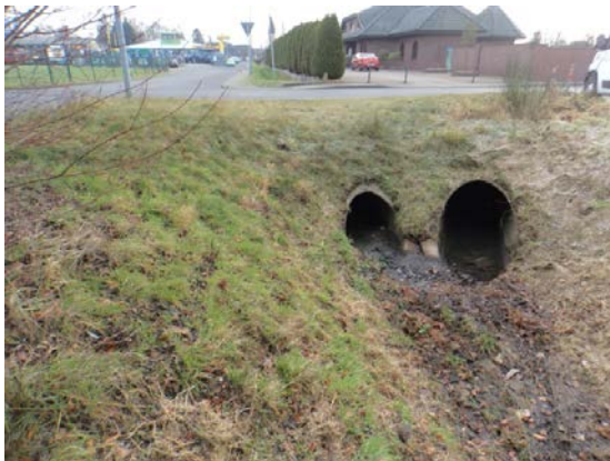
Auslaufbauwerk in den Graben zum Beeckbach
