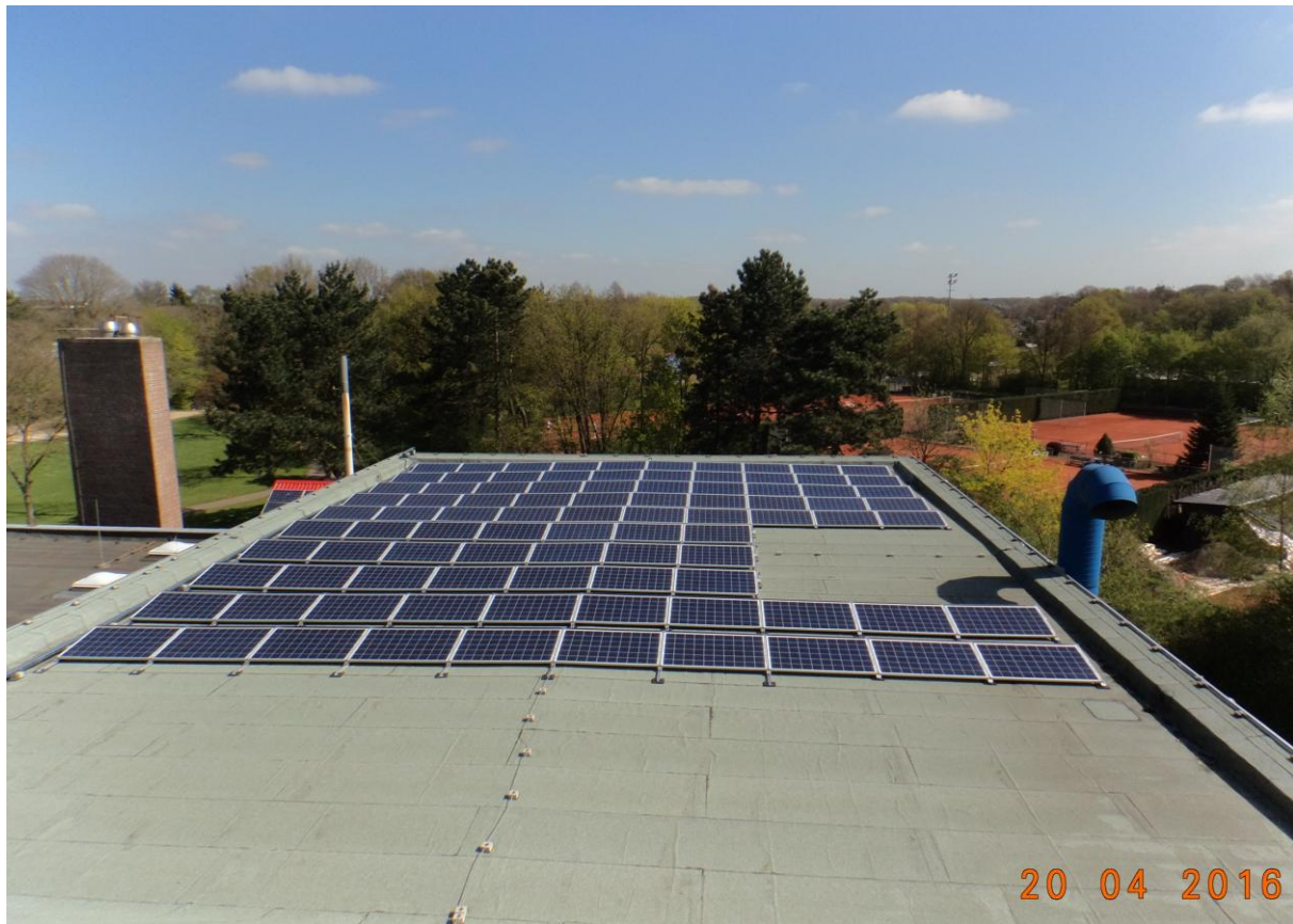
Bild 01: PV-Anlage auf unterer Dachfläche
