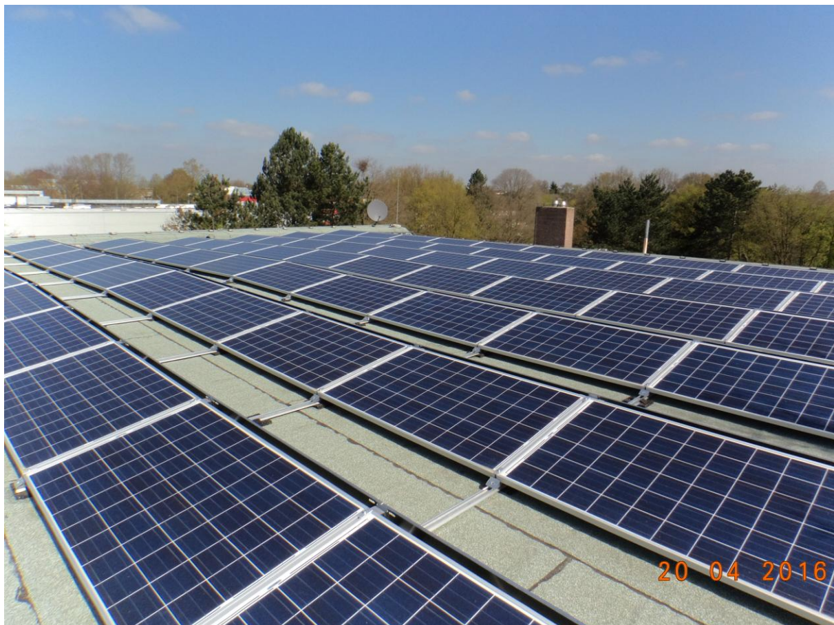
Bild 02: PV-Anlage auf oberer Dachfläche
