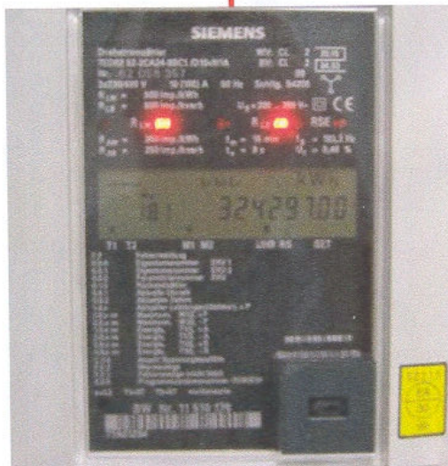
Einspeisezähler (Drehstromzähler mit Impulsausgang)
