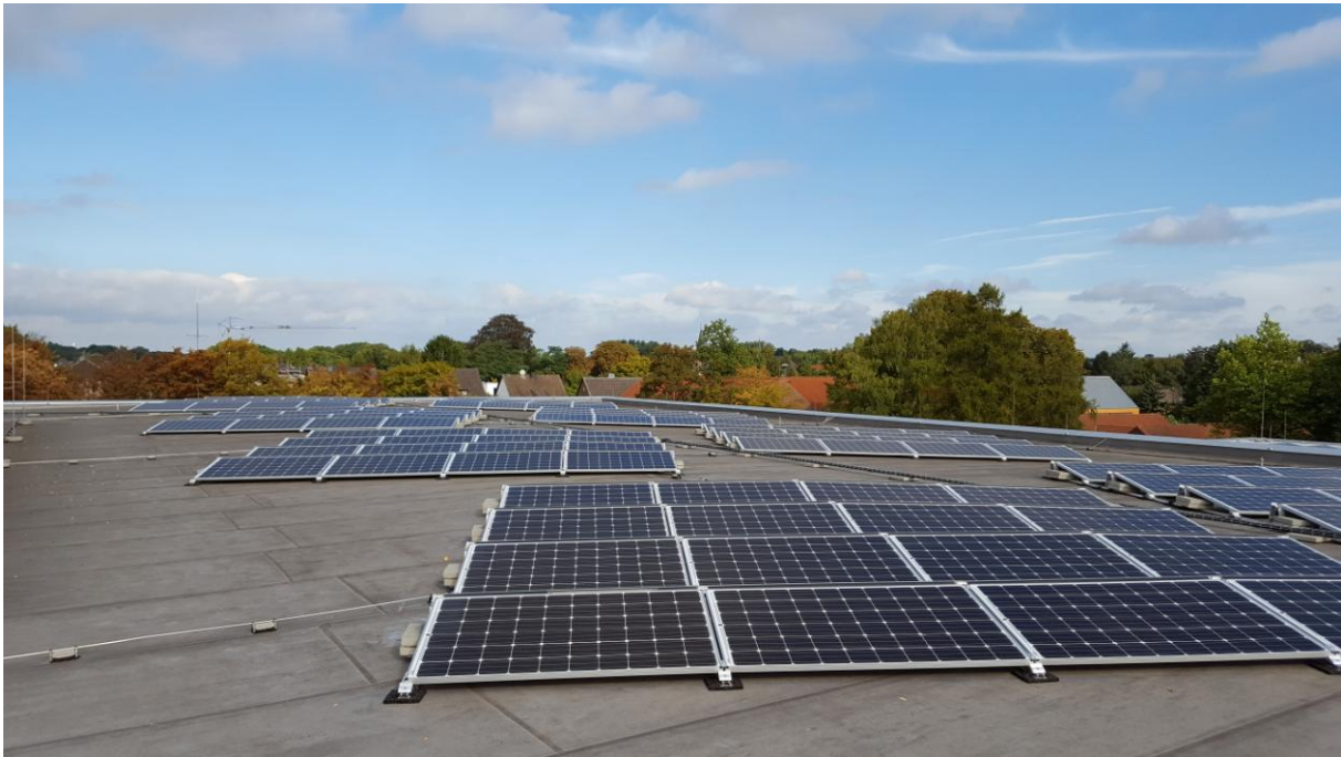
Bild 03: PV-Anlage 2-fach Sporthalle
