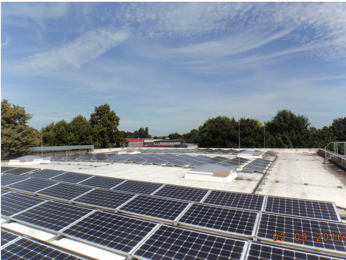
Bild 04: PV-Anlage 3-fach Sporthalle
