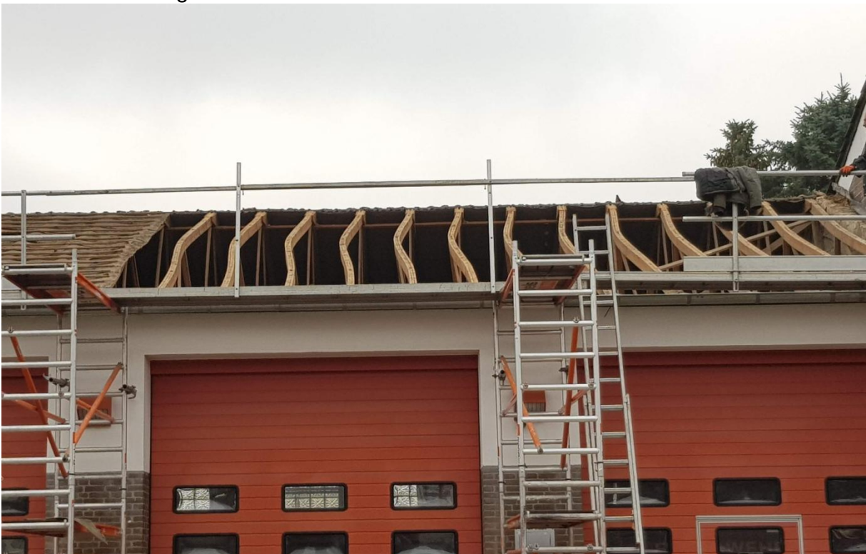
Bild 2: Verformung der Dachbinder
