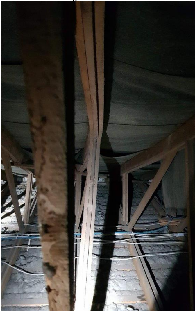
Bild 3: Verformung der Dachbinder
