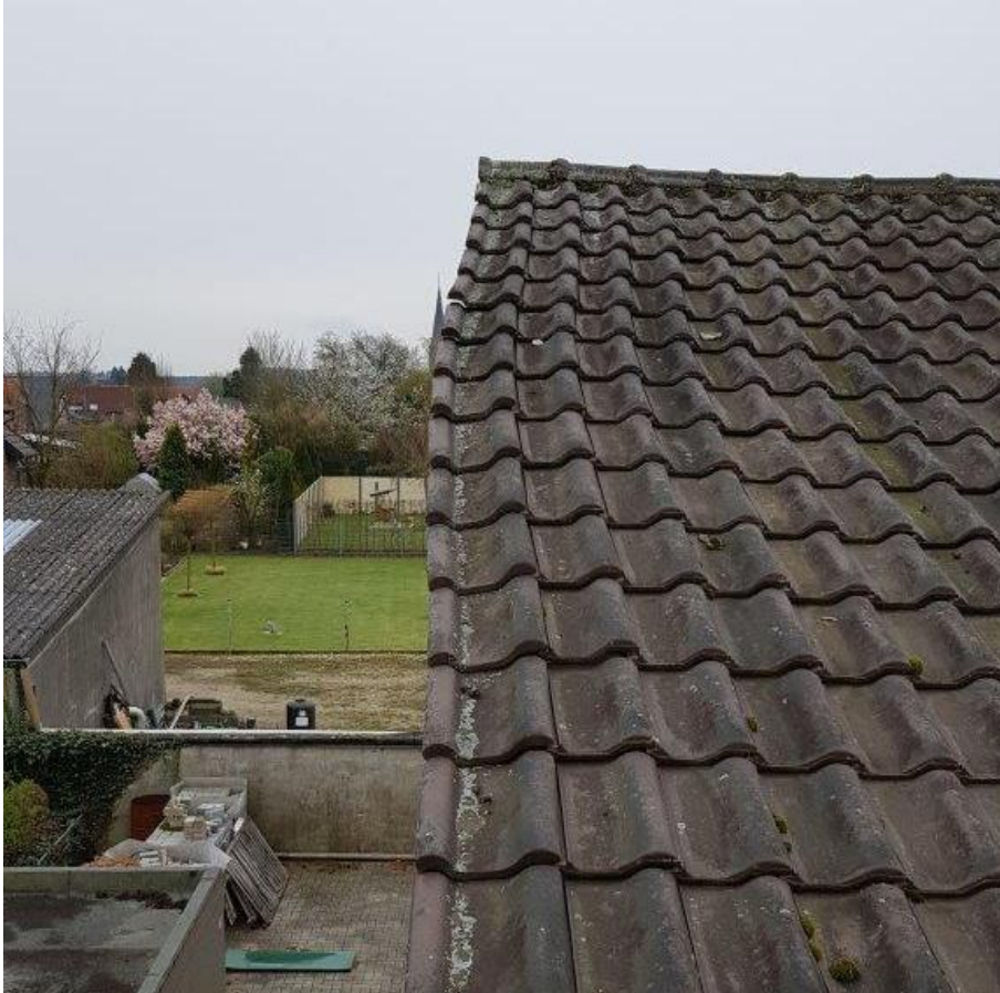
Bild 1: Giebelseite – Ortgang: Verschiebung der Ziegeleindeckung
